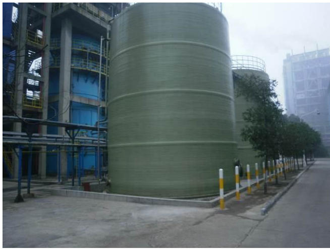
硫酸铵储存罐
