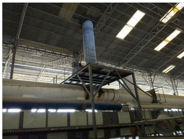
窑尾废气排气筒
