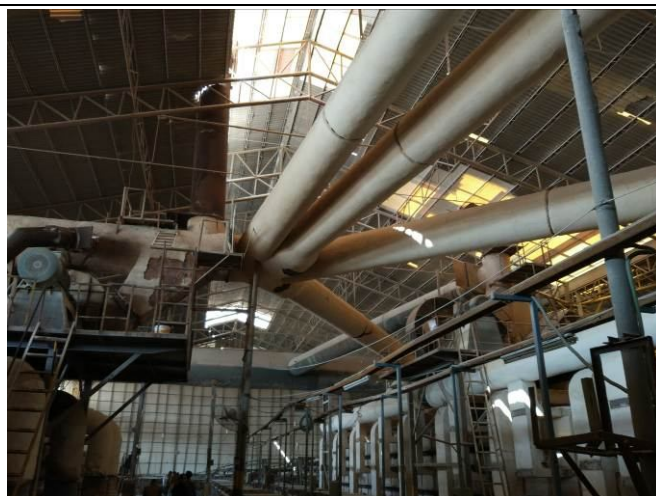
烧成窑炉余热回用管道
