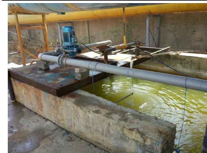
干燥窑脱硫塔喷淋水循环池
