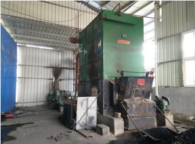
(12#) 2T 燃煤导热油炉
