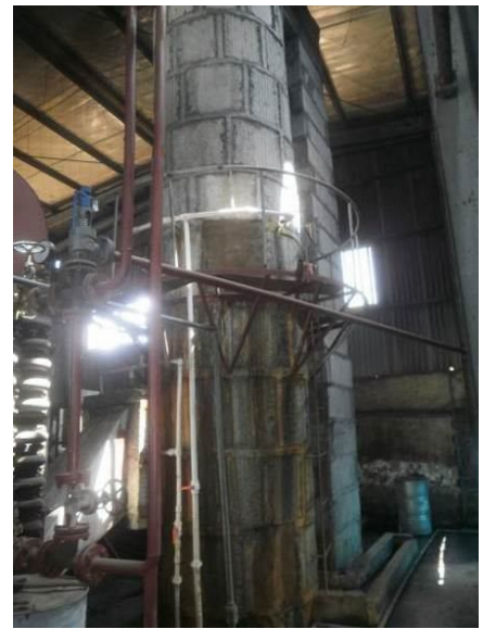
(9#) 锅炉 (4T) 废气处理系统
