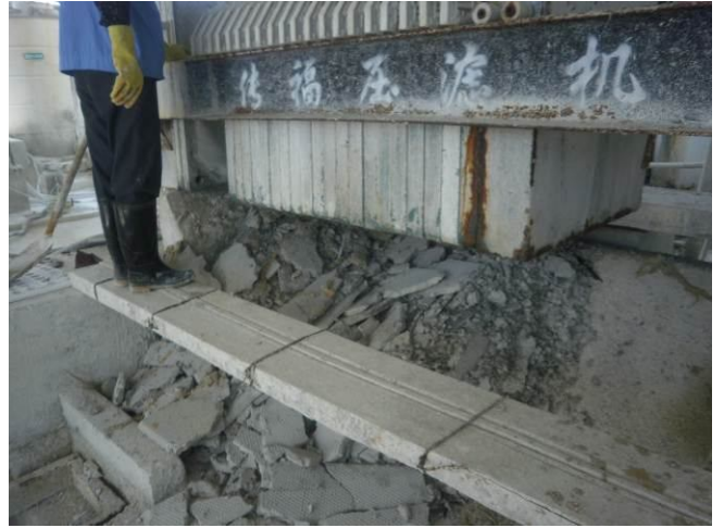
脱氨废水压滤机
