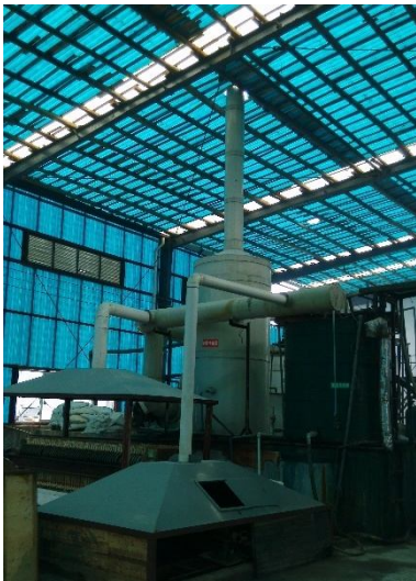
(3#) 酸溶车间（压滤机）废气处理系统
