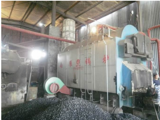
(9#) 4T 燃煤锅炉
