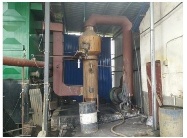
(12#) 导热油炉废气处理系统
