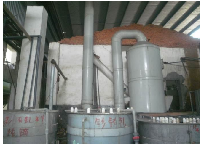
(8#) 沉淀车间废气处理系统
