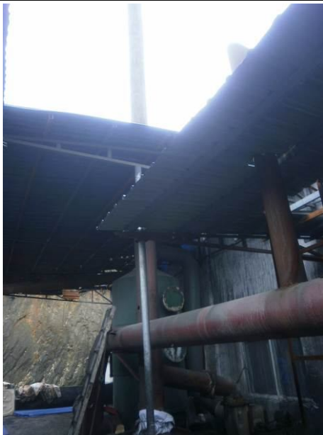
(13#) 碱煮车间碱溶工序排气筒
