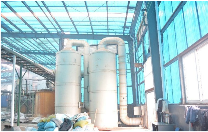
(1#) 酸溶车间（抛光粉）废气处理系统
