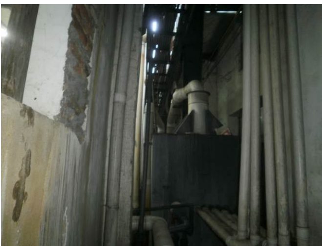
(5#) 萃取一车间酸雾废气处理系统
