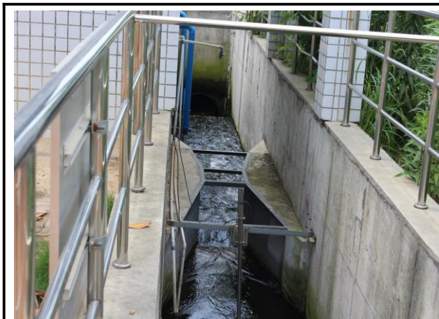
污水处理厂废水出水口
