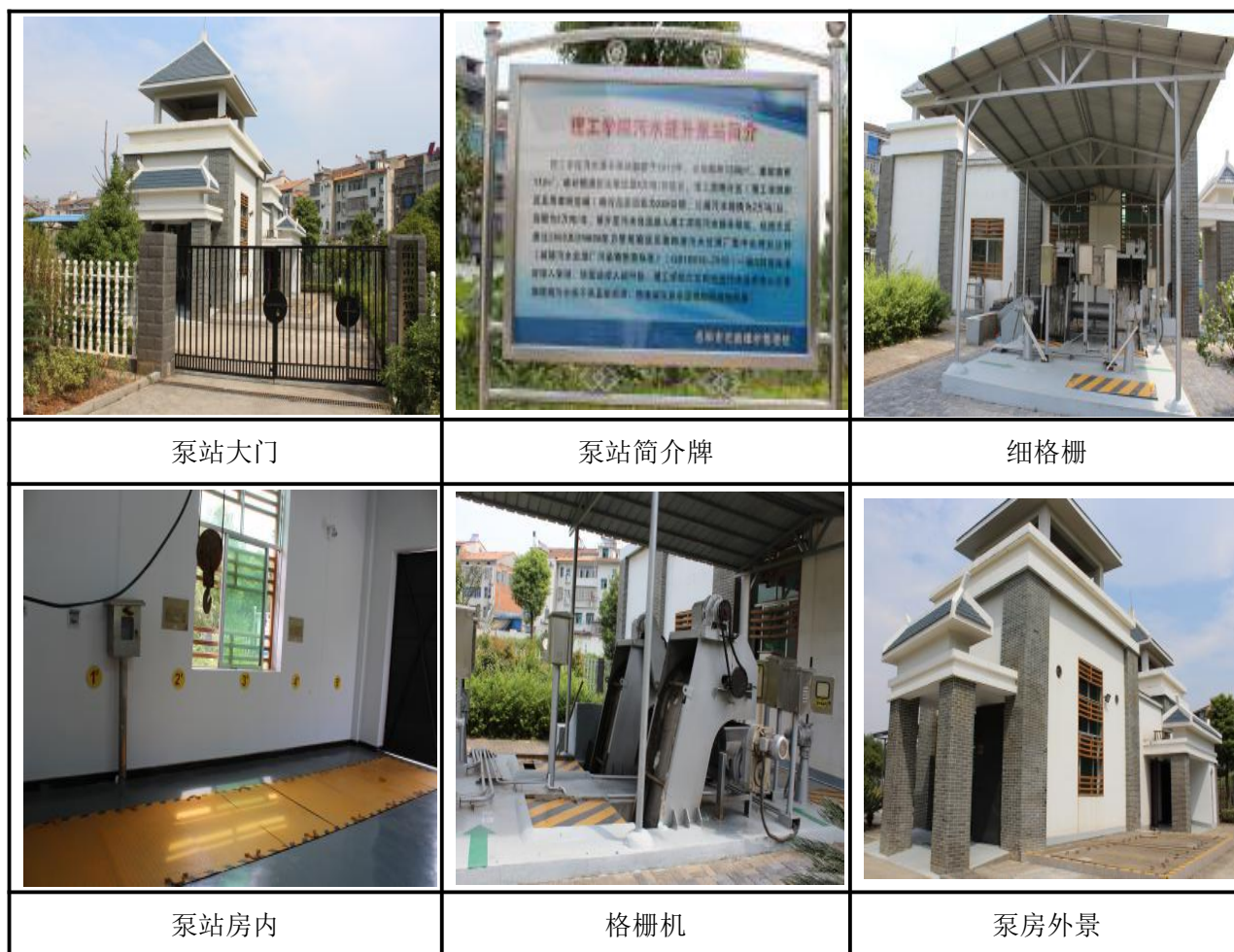
图 3-5 理工学院污水提升泵站
