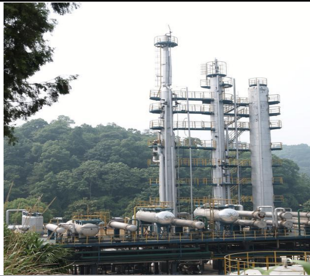
1#污水汽提装置
