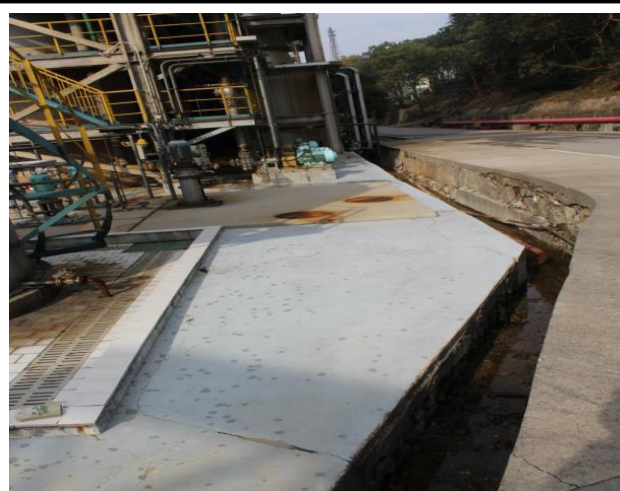
地面冲洗水收集沟（进含油系统）
