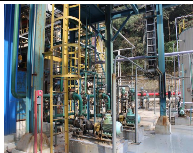
新建脱硫废水处理单元
