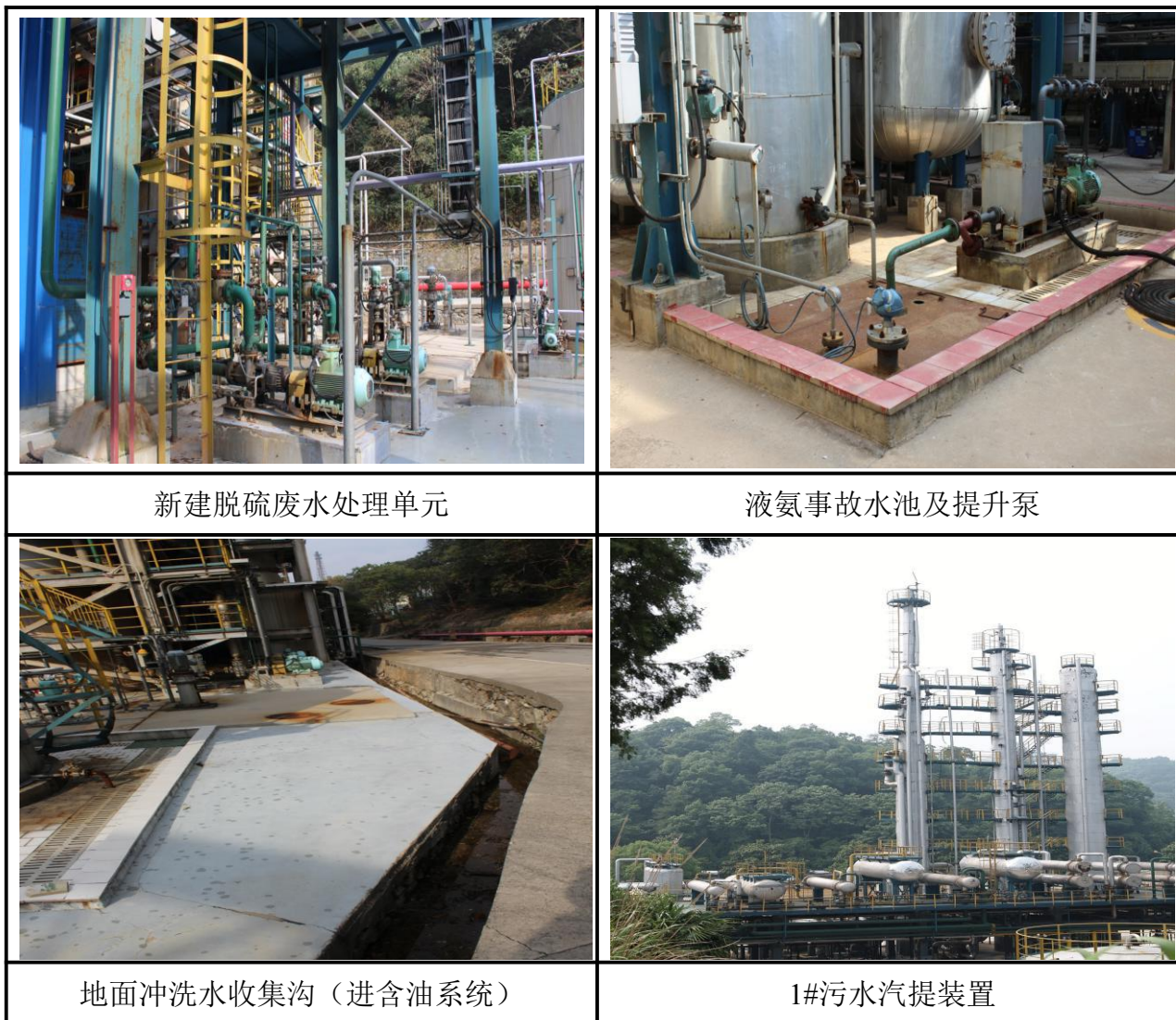
图 3-9 废水部分处置设施
