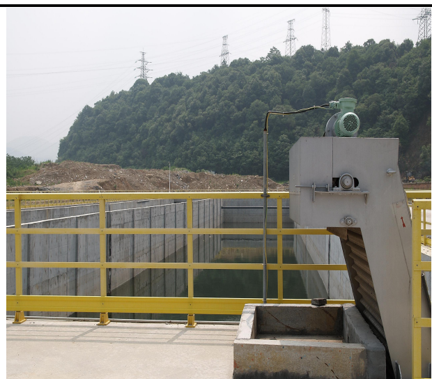
长岭分公司大排事故池
