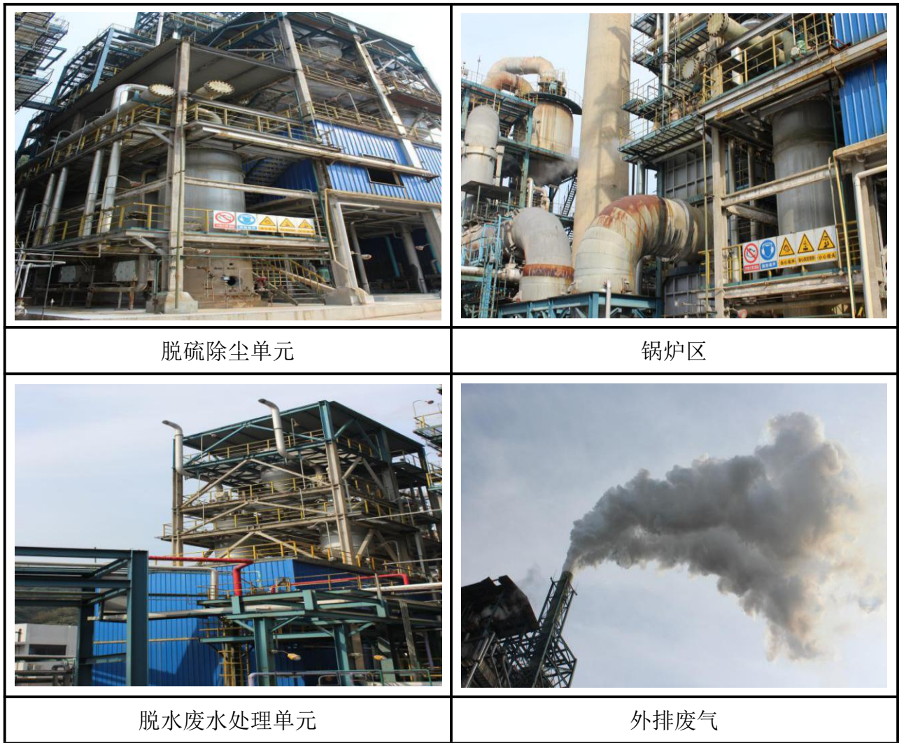
图 3-10 废气部分处置设施
