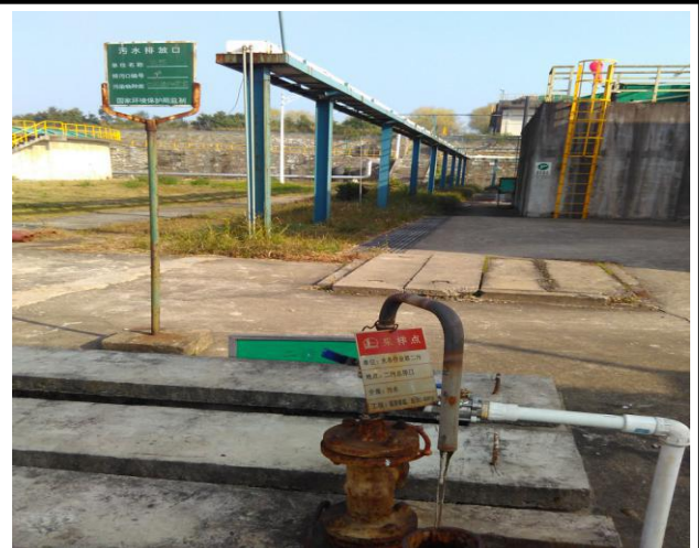
二污总排口及采样点
