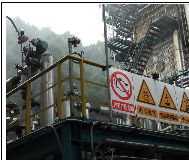
氨区氨检测仪
