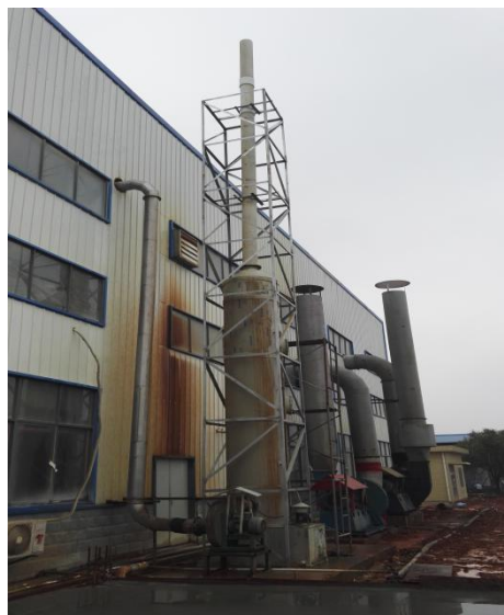
干燥窑炉 15 米排气筒
