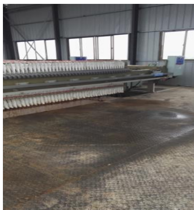
污水处理站污泥压滤
