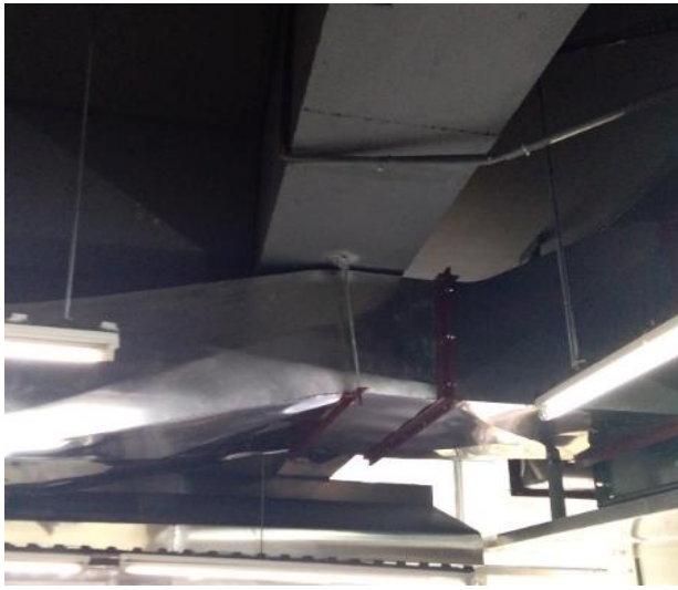
食堂油烟收集管道
