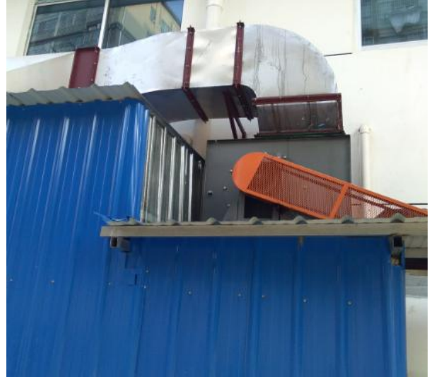
引风机及净化装置
