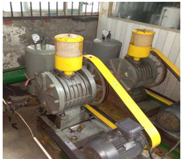
污水处理站鼓风机
