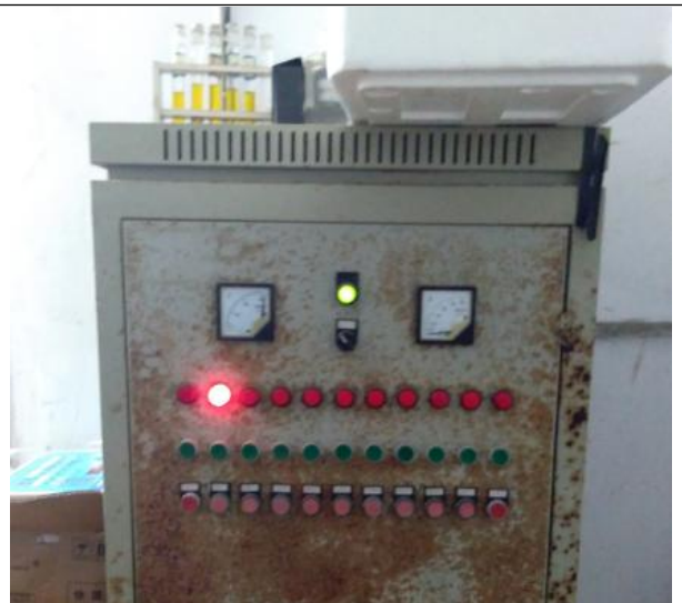
污水站控制柜
