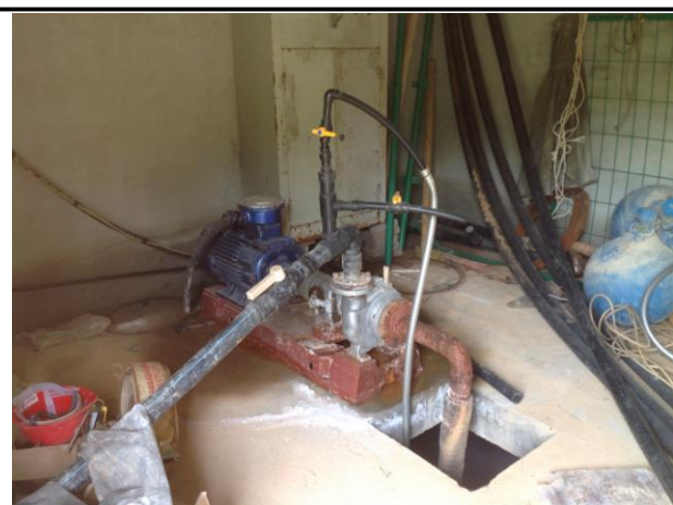
抽排渗滤液机泵及排污管
