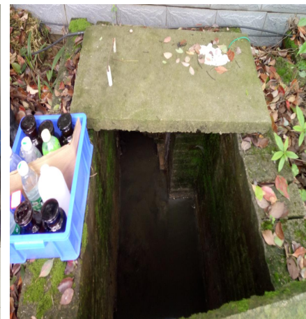
化粪池总排口
