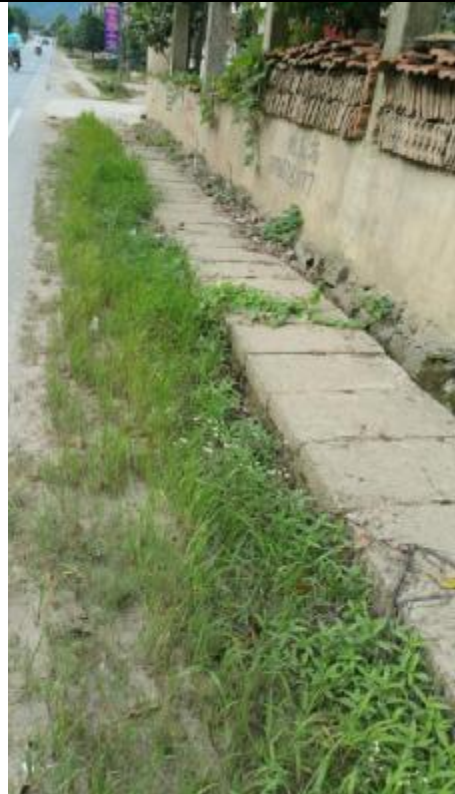
公路两侧排水设施（暗沟）
