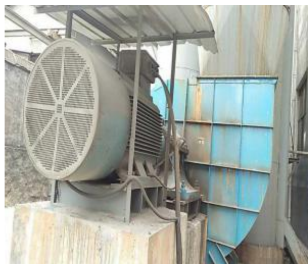
废气处理设施机泵
