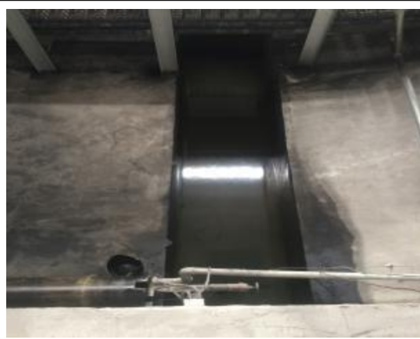
铸锭冷却水收集管道
