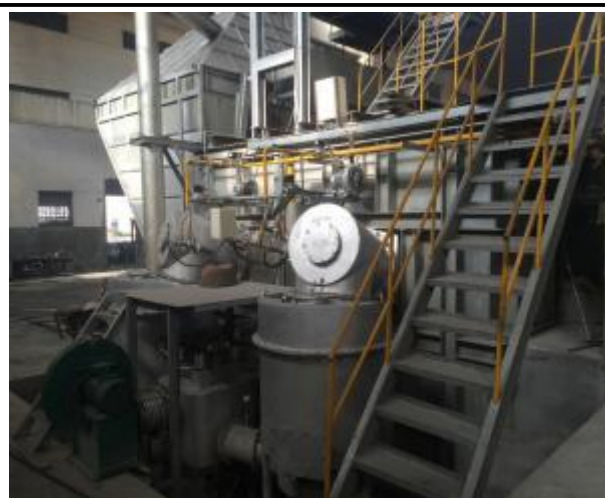
蓄热式燃烧系统 (天然气)
