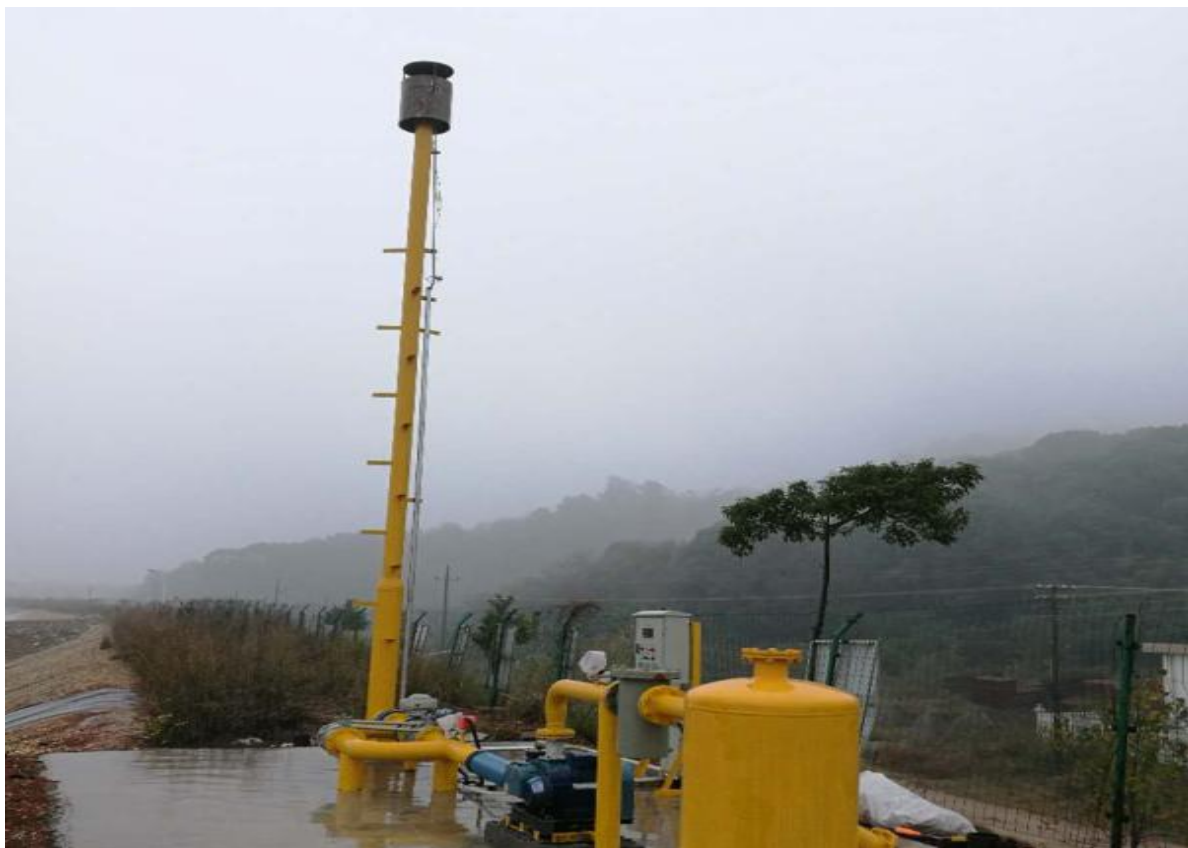
甲烷燃烧装置
