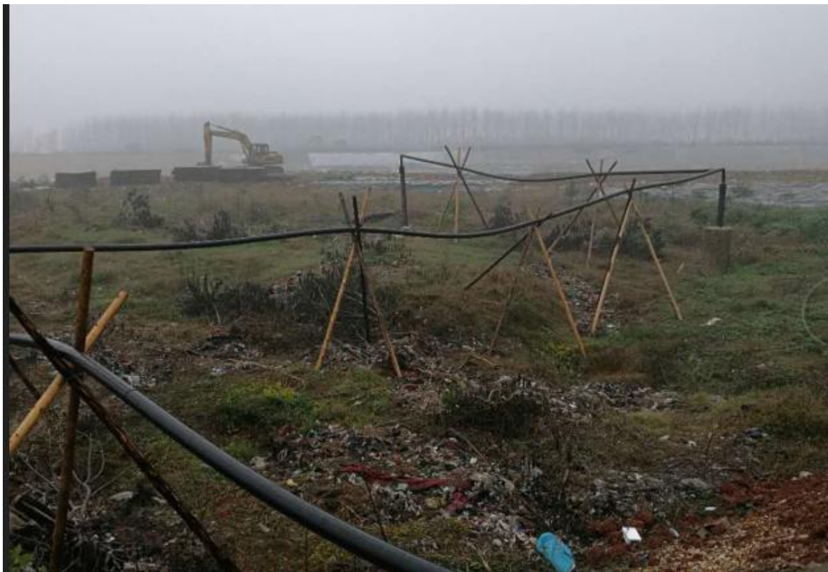
甲烷收集管道
