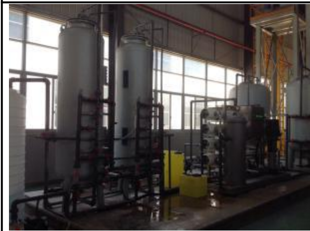
喷涂车间内纯水机组
