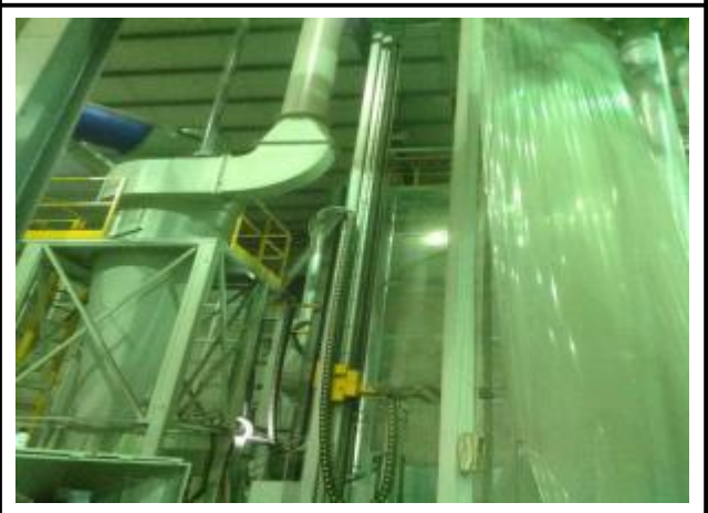
喷涂废气处理（旋风除尘器）
