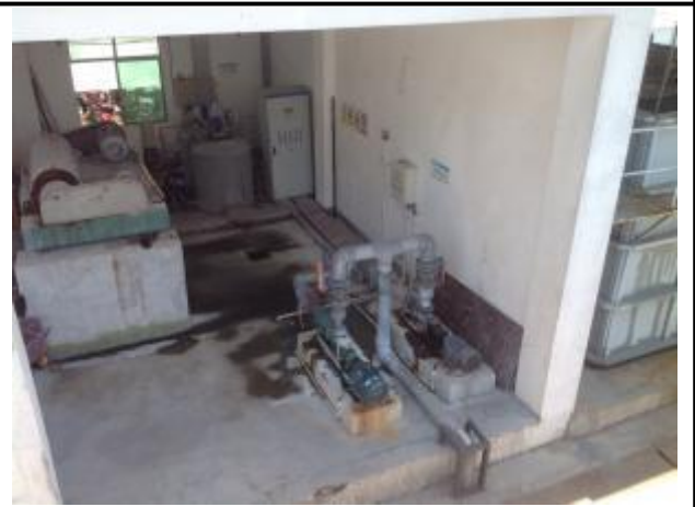
污水处理站机泵
