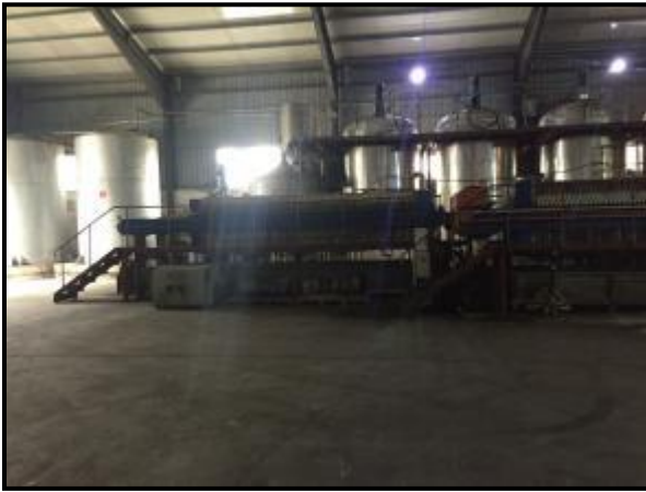
压滤机及储罐
