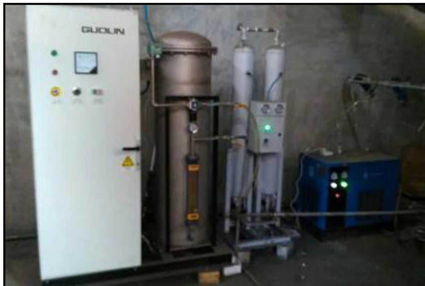
滚筒干燥除臭装置
