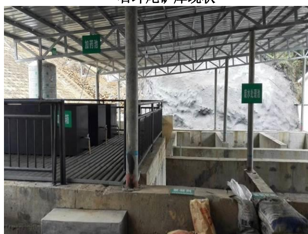
石坪尾矿库坝下废水处理站
