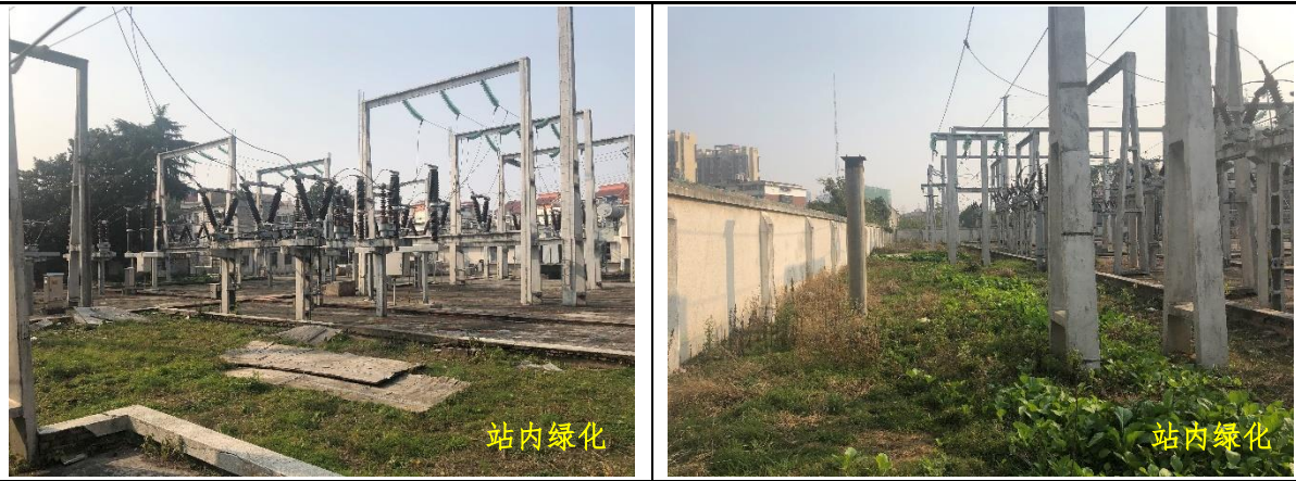
华容 110kV 变电站站内
