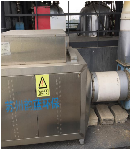
废气处理装置
