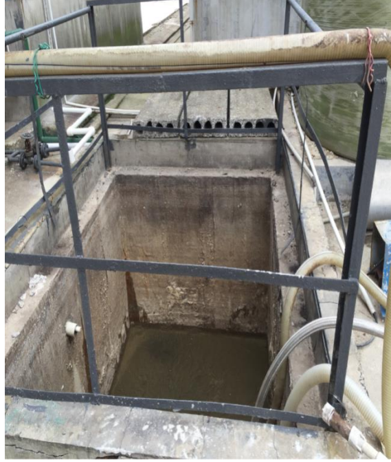
废水收集处理池
