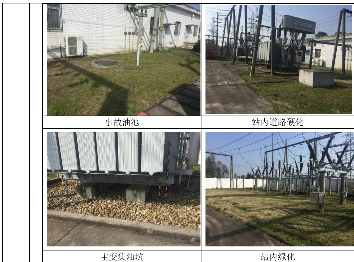
图 2-3 泉新 110kV 变电站环保设施
