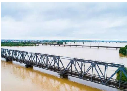
图 3.1-1 京广线铁路桥桥墩被淹
