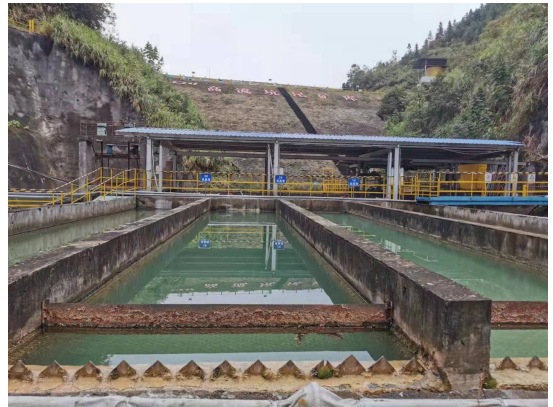
高流坑尾矿库废水处理站
