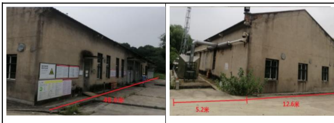
图6.2-17 炼油危险废物暂存间现状图
