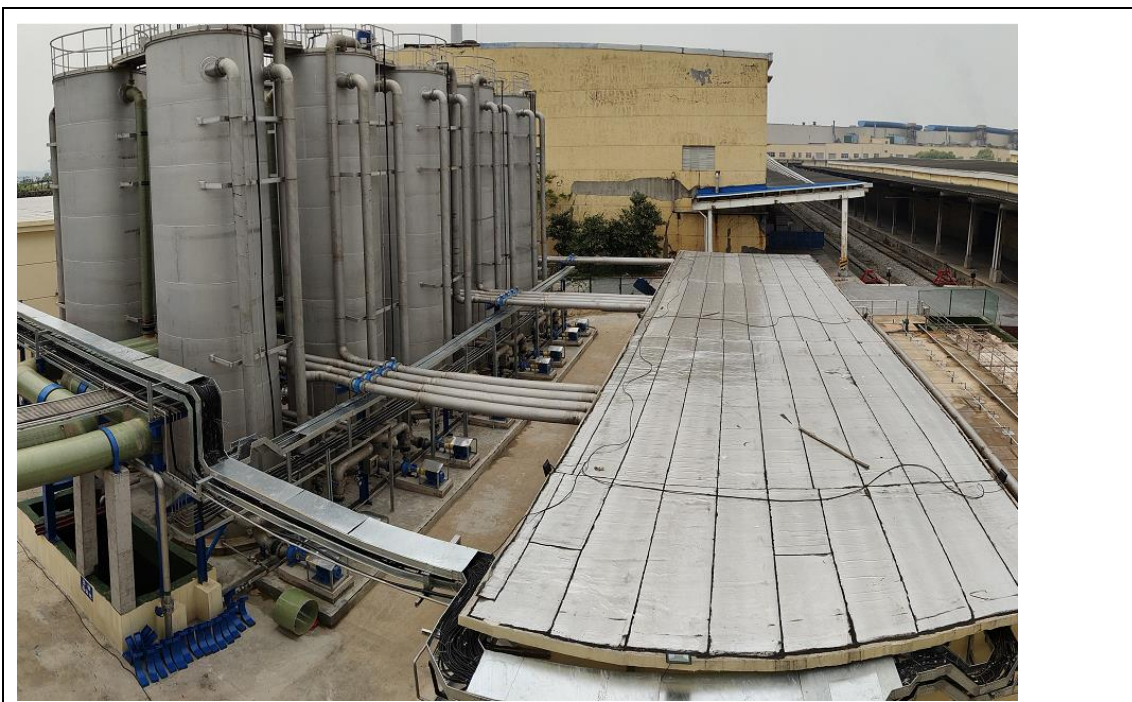
在建污水深度处理系统（芬顿+砂滤）正在通水调试阶段
