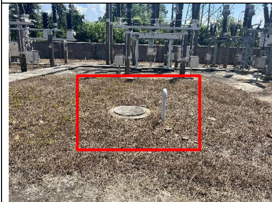
站内事故油池
