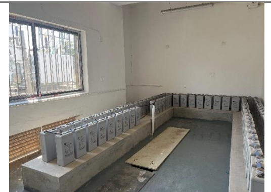
站内铅蓄电池
