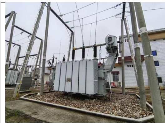
变电站站内#1 主变
