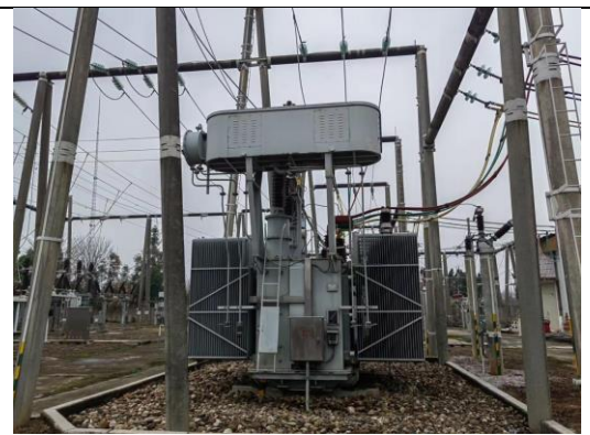
变电站站内 2#主变
