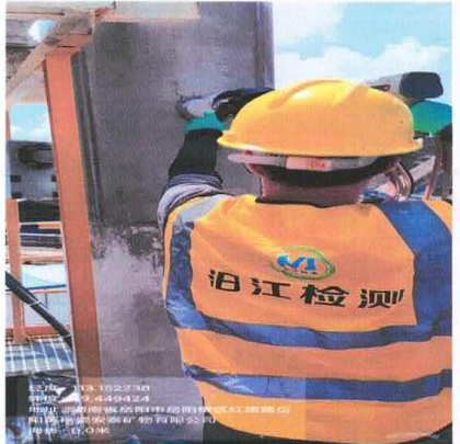
DA003 碳化罐排放口 2
