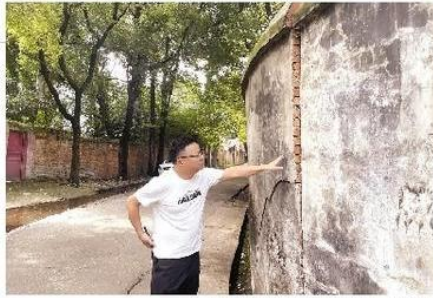
社区工作人员现场查看围墙情况 陈墨摄
